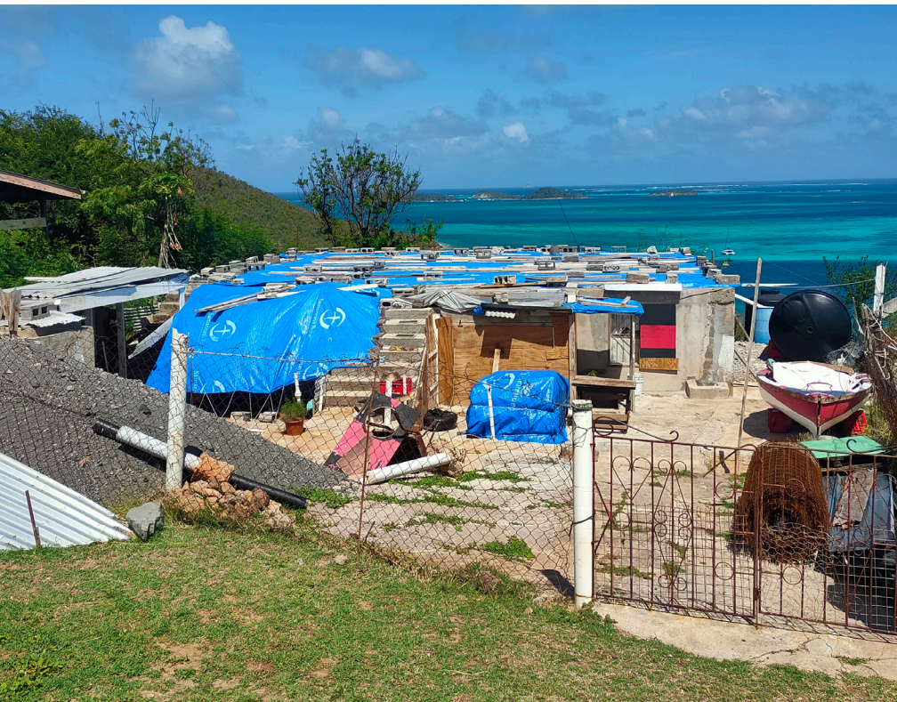
Maison endommagée de l'un des six employés postaux.
